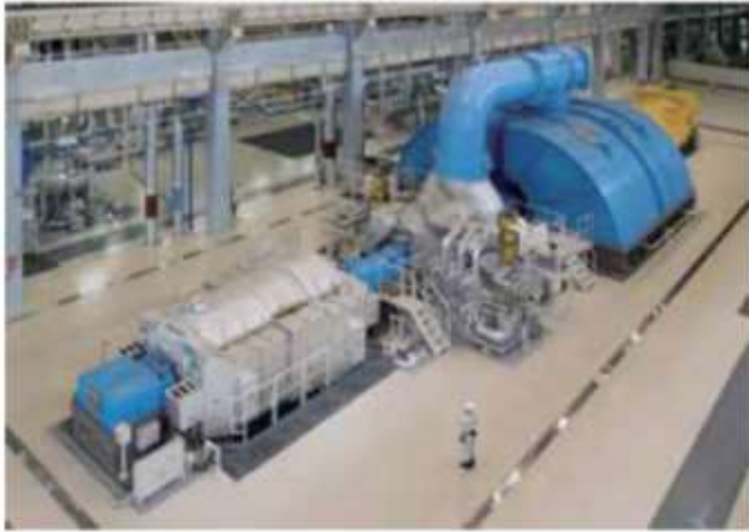
蒸気タービン
